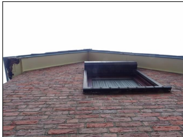
Figuur 18. Overhangende kantpannen, open tootvoegen ontbreken.
