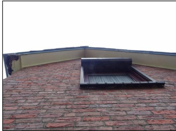
Figuur 18. Overhangende kantpannen, open tootvoegen ontbreken.
