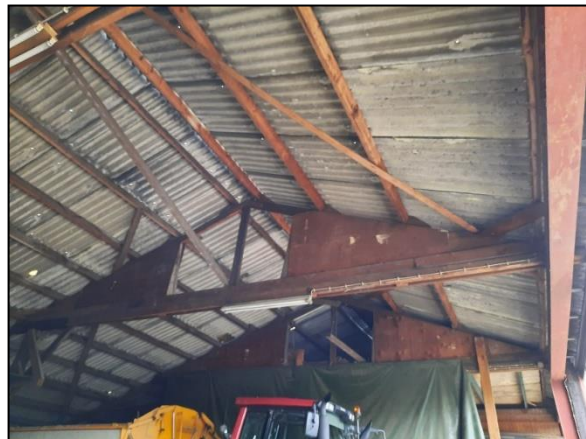
Figuur 20. Enkele laag dakbedekking in de schuur, zonder beschot.
