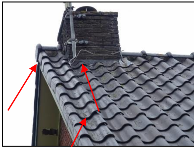
Figuur 10. Dak van het woonhuis met ruimtes bij de schoorsteen, in de nok en bij de overhangende kantpannen.
