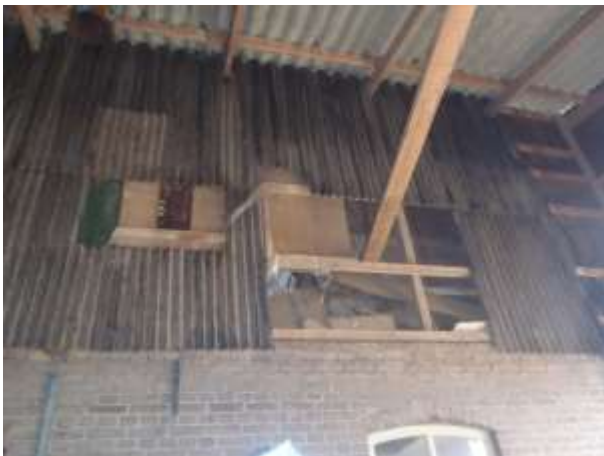
Foto 15: onderzijde overkapping als op foto 14 met de ontbrekende beplating waardoor dieren eenvoudig op de zolder van de Wehlseweg 19 kunnen komen.
