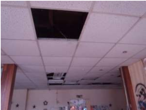
Foto 5: ststeemplafond Wehlseweg 19. Een aantal tegels ontbreekt in het plafond.
