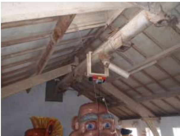
Foto 8: de zolder boven de schuur achter de Wehlseweg 19. Op de stalenbuis liggen op enkele plaatsen (oude) vogelnesten
