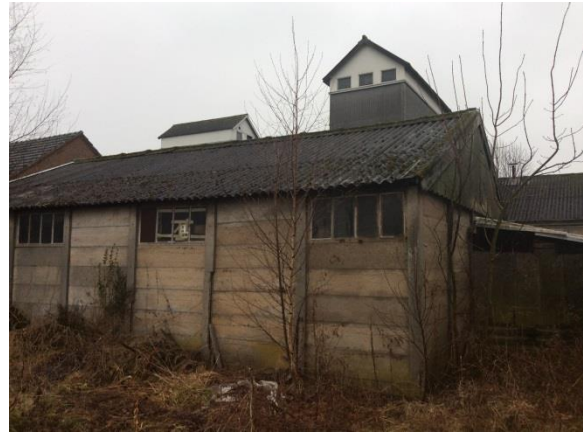
Figuur 9: Bebouwing zonder dakgoot
