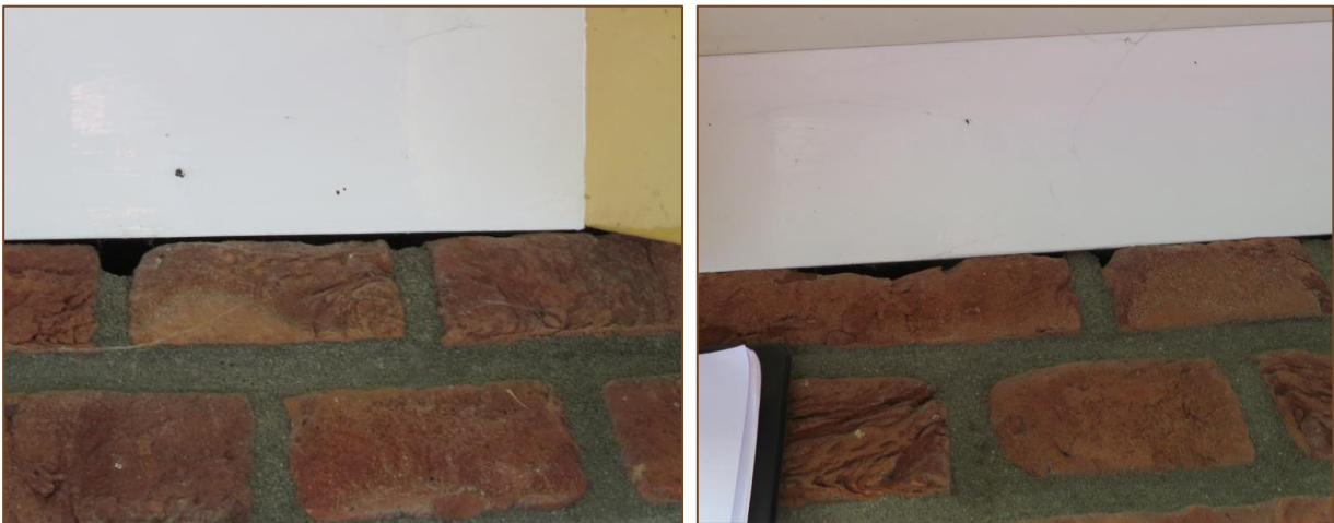
Foto 1 en 2. Kier langs de gevelbetimmering (foto's: R. Top).
