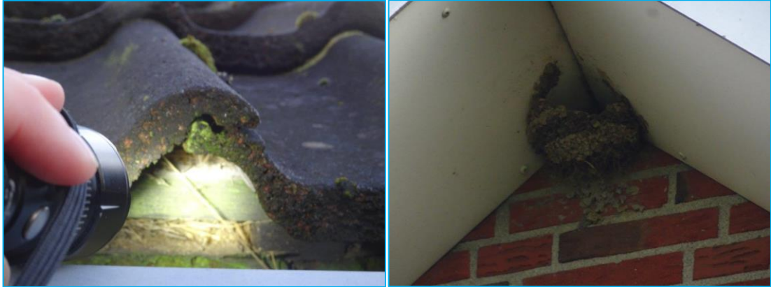
Foto's: Nestresten onder dakpannen te handhaven woning en nestresten huiszwaluw onder de overstek van deze woning.
