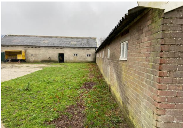
Figuur 16: Asbestverdachte golfplaten
