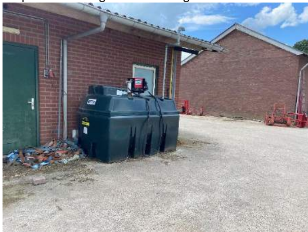
Figuur 13: Bovengrondse dieseltank bij varkensschuur
