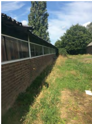
Figuur 8: Asbestverdachte dakbedekking
