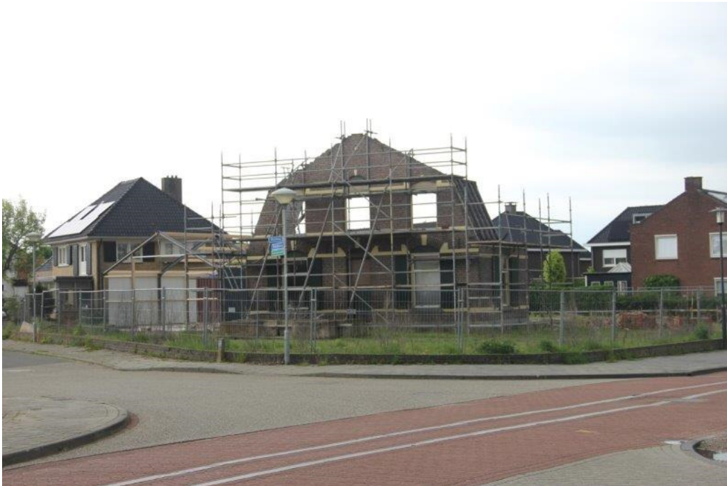
Het te verbouwen pand aan de Oude Doetinchemseweg vanaf het grasveldje aan molenzijde van de oude Doetinchemseweg; kijkrichting NNW. Links van de steigers de staalconstructie van het bijgebouw. Bij beide foto's moet opgemerkt worden dat het bijgebouw nu groter is dan uiteindelijk vergund gaat worden, en het uiteindelijke bijgebouw dus kleiner gaat worden dan zichtbaar op deze foto's.
