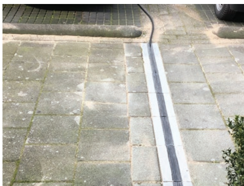
Kabelgoot elektrisch opladen openbare ruimte
