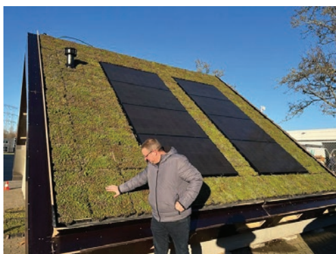
Zonnepanelen op het dak
