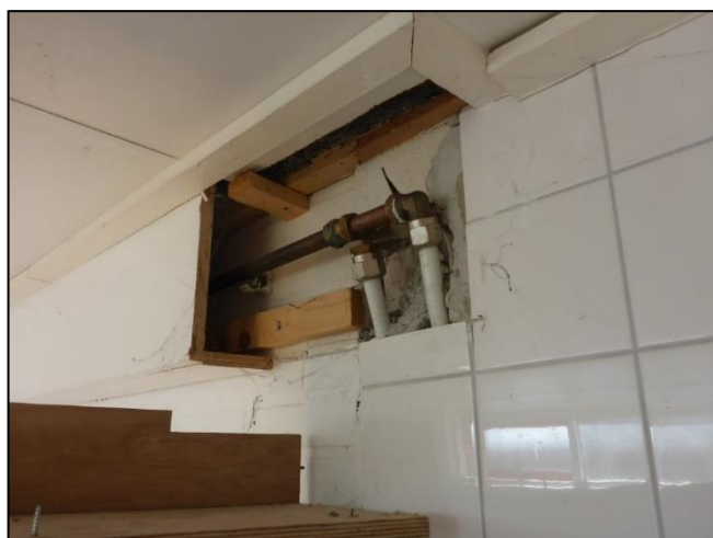
Foto 24: Kleedruimte: Installatiewerk (Niet asbestverdacht)
