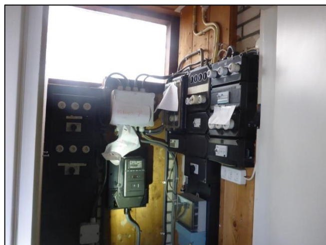
Foto 12: Meterkast (Niet asbestverdacht)
