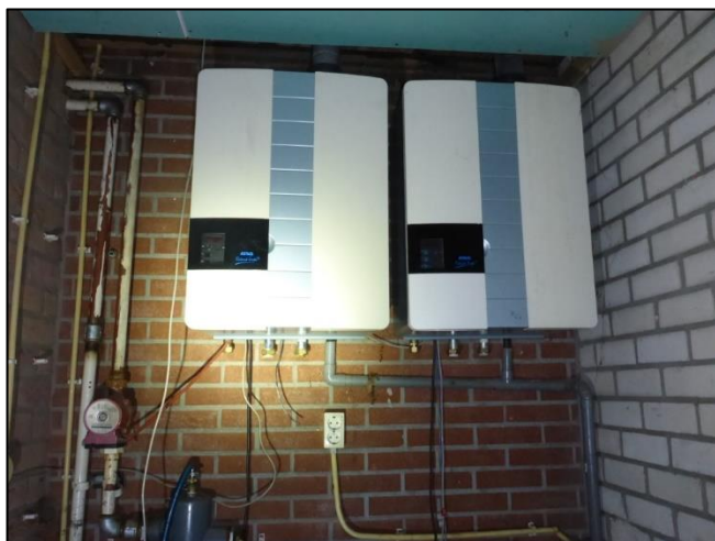
Foto 19: CV-ruimte: Verwarmingsketels (Niet asbestverdacht)
