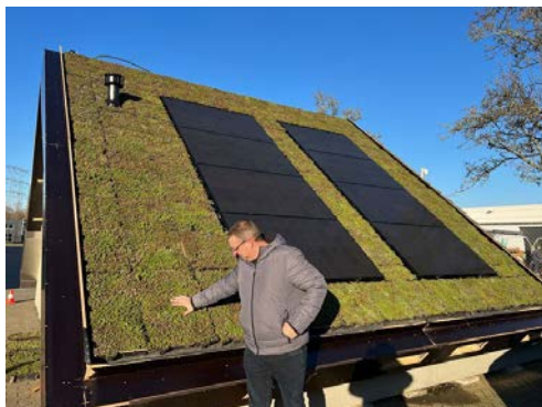
Zonnepanelen op het dak
