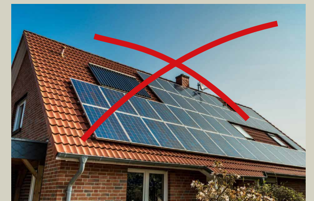
Niet zo: achteraf rommelig opgeplakte PV-panelen
