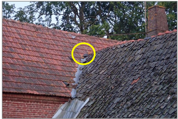
Afbeelding 3.4 | opening in het beschadigde dak gebruikt door de steenmarter om naar de zolder toe te komen
