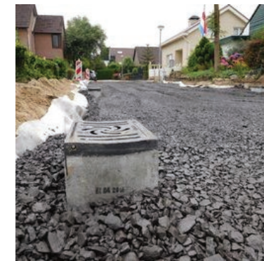
Waterbergende weg met kolkafvoer
