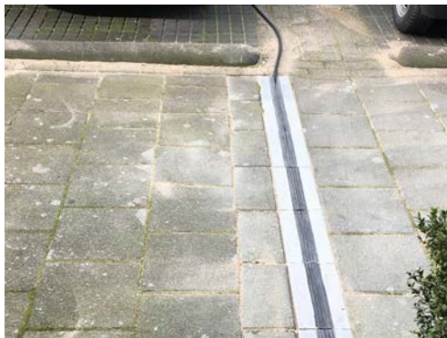
Kabelgoot elektrisch opladen openbare ruimte
