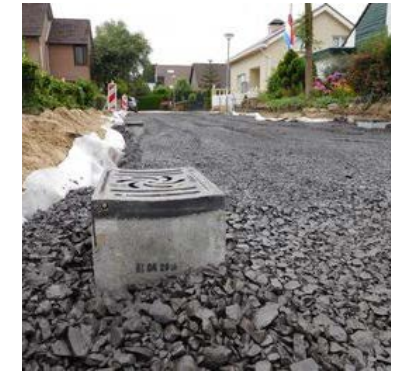
Waterbergende weg met kolkafvoer
