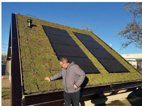
Zonnepanelen op het dak
