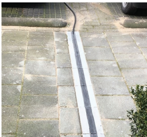
Kabelgoot elektrisch opladen openbare ruimte
