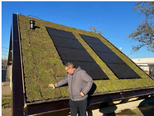
Zonnepanelen op het dak
