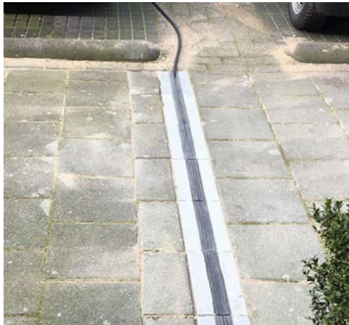
Kabelgoot elektrisch opladen openbare ruimte
