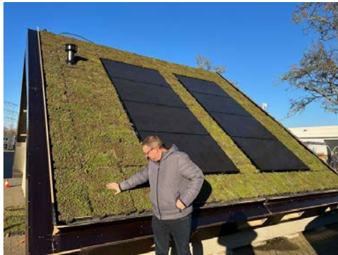
Groen hellend dak met zonnepanelen
