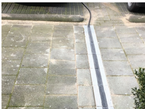
Kabelgoot elektrisch opladen openbare ruimte
