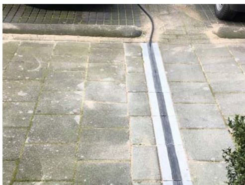
Kabelgoot elektrisch opladen openbare ruimte
