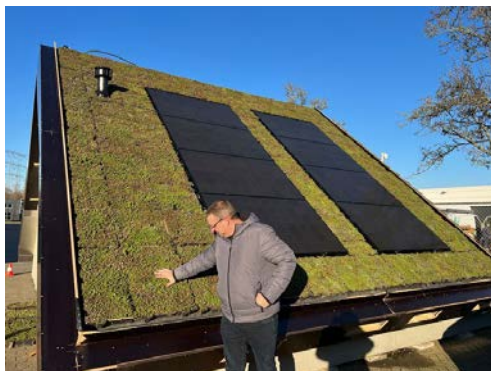
Groen hellend dak met zonnepanelen
