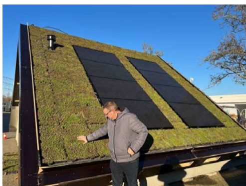
Zonnepanelen op het dak
