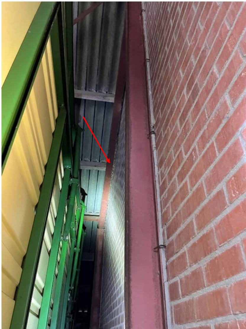
Figuur 3-8 Nestmateriaal tussen draagbalken bij gebouw 3. Foto: RHDHV, februari 2022.
