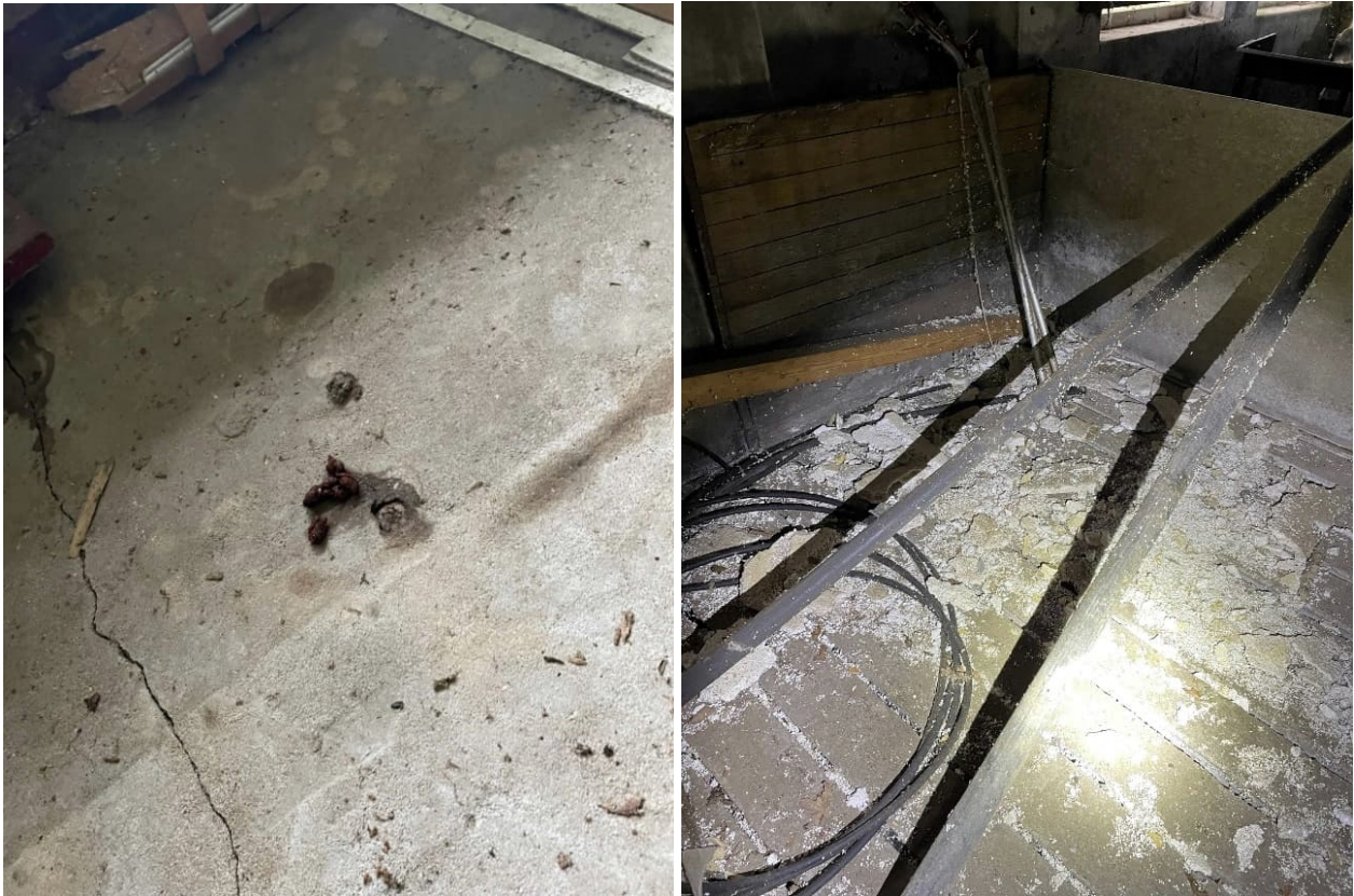
Figuur 4-6 Links verse marterpoep gebouw 4 en rechts kapotgemaakt piepschuim kalverstal gebouw 4. Foto's: RHDHV, februari 2022.
