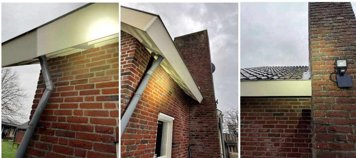
Figuur 3-7 Impressie gebouw 2: kieren tussen dakbedekking en buitenmuur (links en midden) en kieren tussen dakbedekking en schoorsteen (rechts). Foto's: RHDHV, februari 2022.
