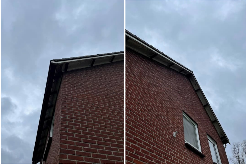
Figuur 3-15 Impressie gebouw 8: overhangend dakbeschoot met kieren en openingen. Foto: RHDHV, februari 2022.
