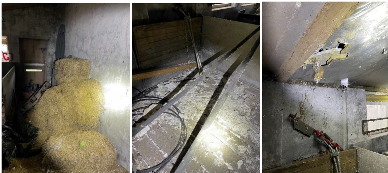
Figuur 3-10 Impressie gebouw 4 kalverenstal: met links hooibalen, in het midden verscheurd piepschuim en rechts los isolatiemateriaal. Foto's: RHDHV, februari 2022.
