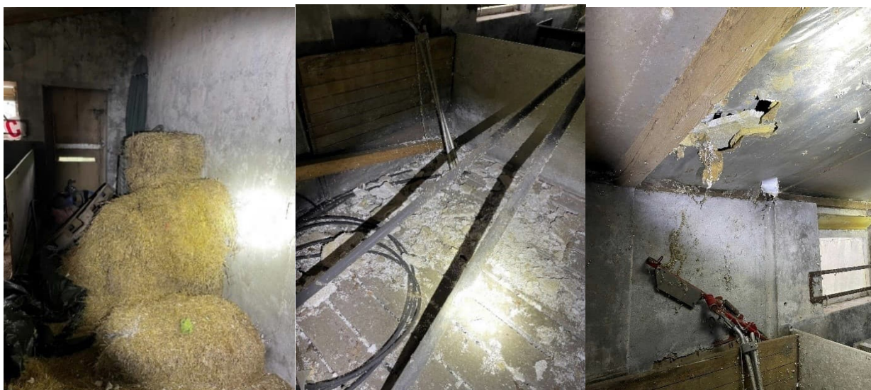
Figuur 2-9 Impressie gebouw 4 kalverenstal: met links hooibalen, in het midden verscheurd piepschuim en rechts los isolatiemateriaal. Foto's: RHDHV, februari 2022.
