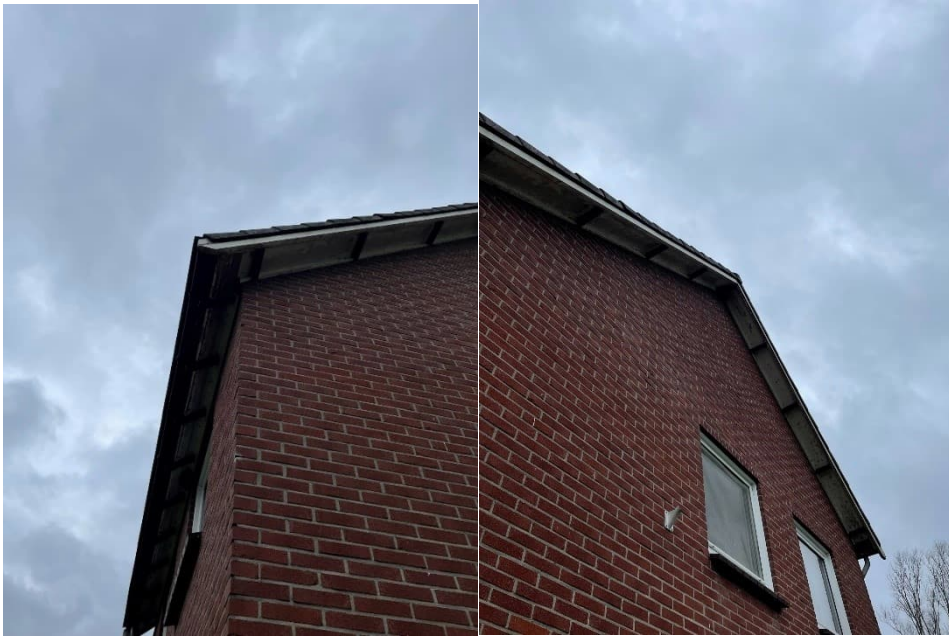
Figuur 2-14 Impressie gebouw 8: overhangend dakbeschot met kieren en openingen. Foto: RHDHV, februari 2022.
