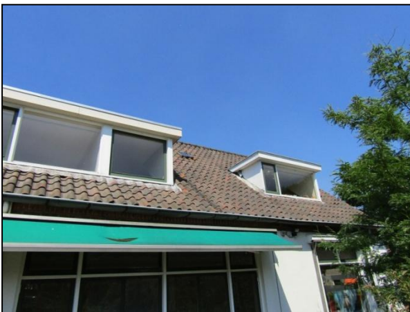
Figuur 10. Dak van het voorgebouw met toegang tot de ruimte onder dakpannen via de regenpijp en beschadigde dakpannen.
