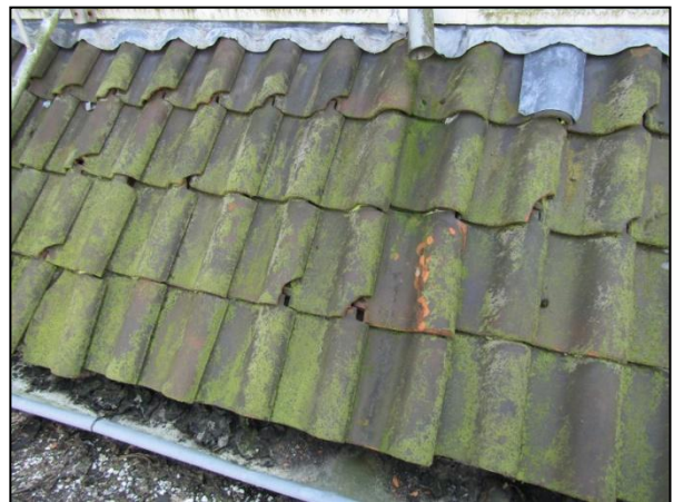
Figuur 11. Beschadigde dakpannen bieden toegang tot de ruimte onder de dakpannen.
