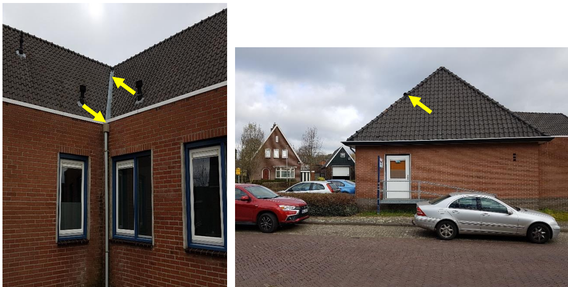
Figuur 6. Openingen langs dakpannen naast de kilgoot en boven een regenpijp (links); Opening bij een loszittende nokvorst (rechts).
