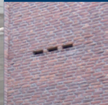
Maatwerk inbouwkasten bij het gebouw van het Wereld Natuurfonds in Zeist
