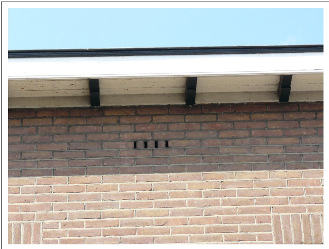
Foto 2. Open stootvoegen in woonhuis nr. 10, toegankelijk voor vleermuizen.
