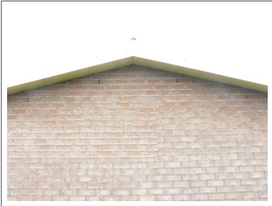
Foto 3. Open stootvoegen die vlemuizen toegang kunnen verlenen tot de spouwmuur.
