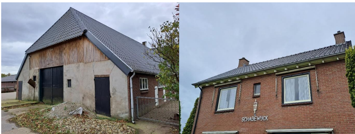
De dakpannen van de woning en het achterhuis sluiten strak op elkaar aan zonder kieren of openingen.
