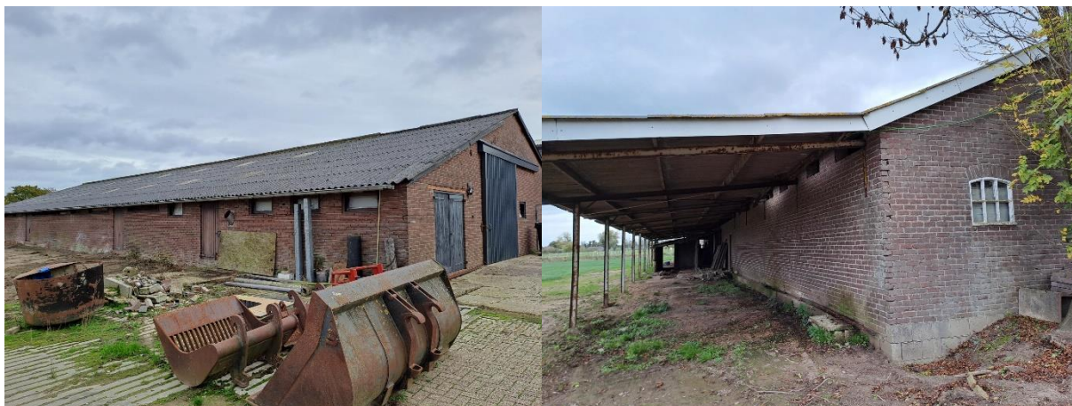
Amfibieën kunnen een (winter)rustplaats bezetten onder verspreide spullen/materialen in de buitenruimte en opgeslagen in de werktuigenberging en onder het afdak.
