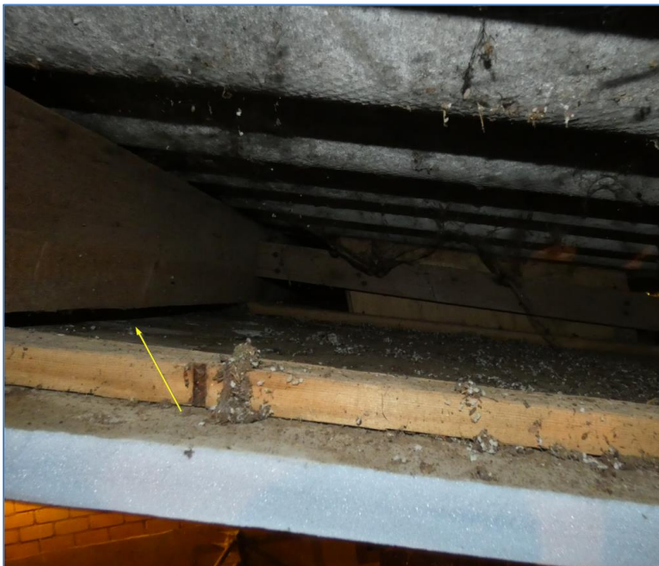
Foto 8. Tochtkier isolatie en gordingen (gele pijl)
