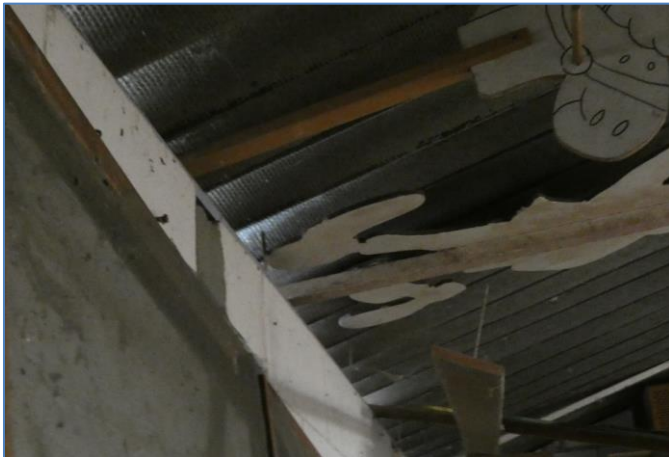
Foto 10. Dak voorgebouwtje zonder isolatie
